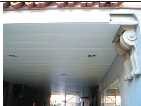
Si la restauration du passage de la couronne avait bien commencé avec l'arrachage du carlage, cela se termine fort mal avec la pose d'un plafond métallique blanc.
